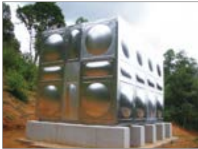
광명시 도덕산 야영장 STS판넬탱크
